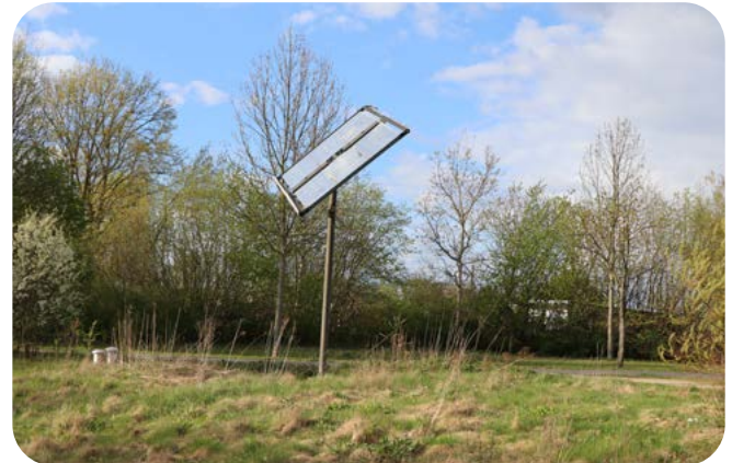
Abb. 22: Pumpe mit Solarpanel am Krugpfuhl, Pankow, 2017. Inzwischen infolge von Vandalismus funktionslos und zurückgebaut. Foto: S. Bengsch
